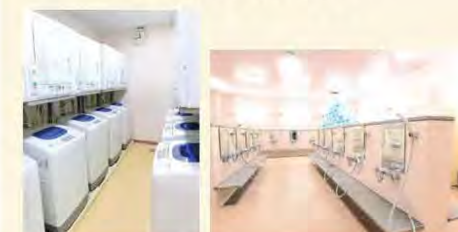
ランドリー室
